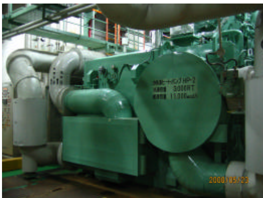
写真3 後楽一丁目ポンプの熱回収型ヒートポンプ (いずれも筆者撮影)
