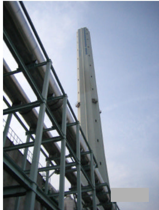
写真 8 東部スラッジセンターの污泥焼却炉煙突 (筆者撮影)
