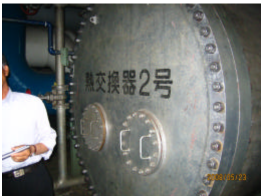
写真2 後楽一丁目ポンプのシェルアンドチューブ熱交換器
