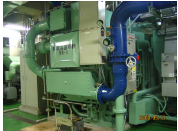
写真6 砂町水再生センター内ガス吸収冷温水機 (筆者撮影)
