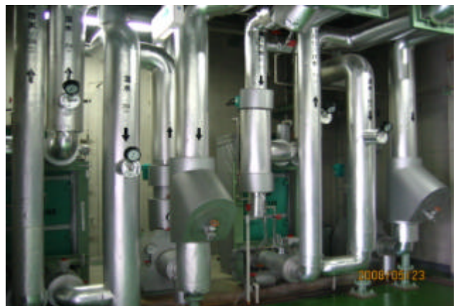
写真7 砂町水再生センター内の熱交換機 (筆者撮影)
