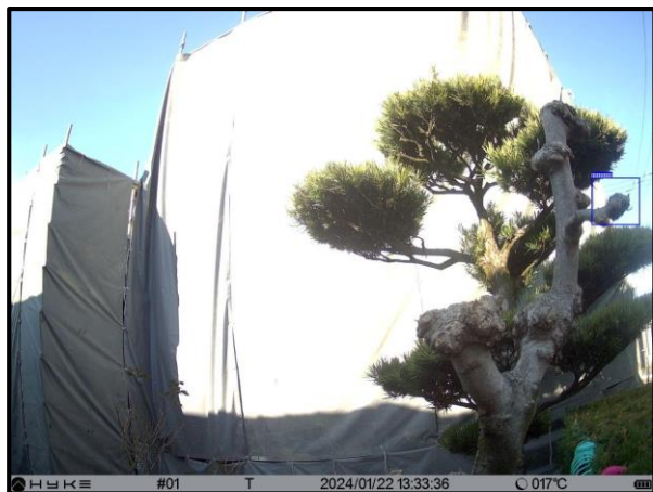
ヘルメットの未着用（誤り）
