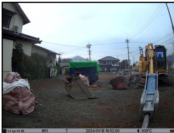
ヘルメットの未着用（誤り）
